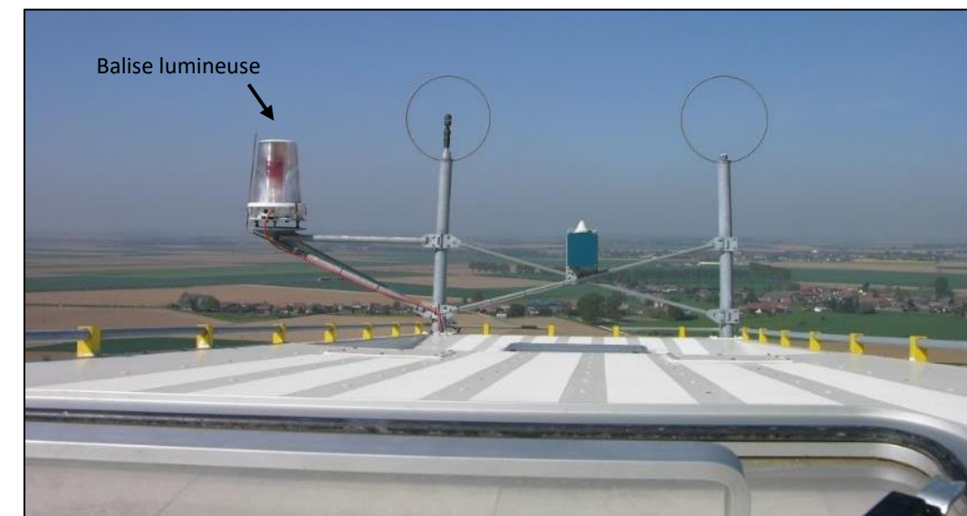
Figure 26 : Système de balisage lumineux (Source : EOLISE)
